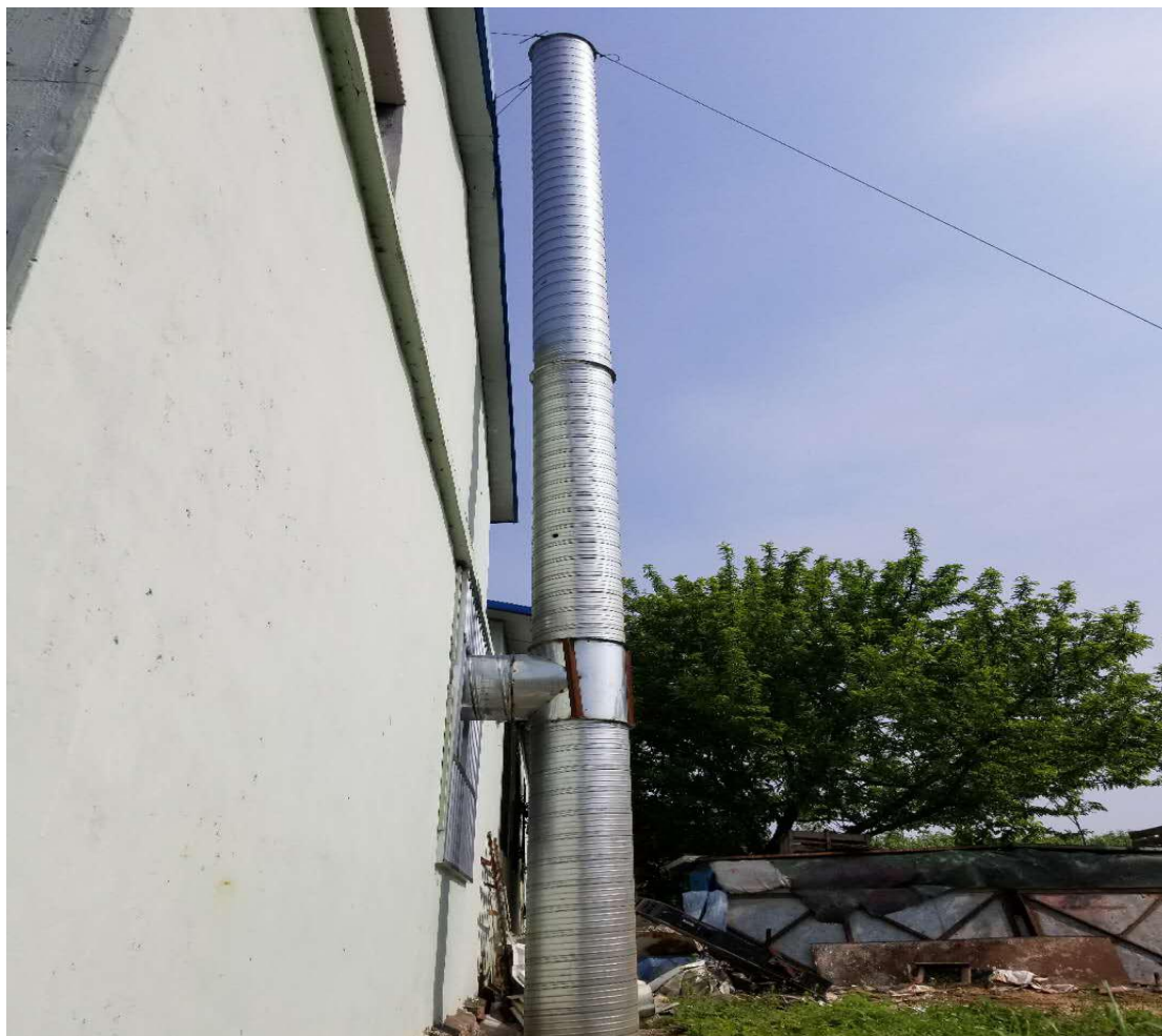
废气排气筒照片
