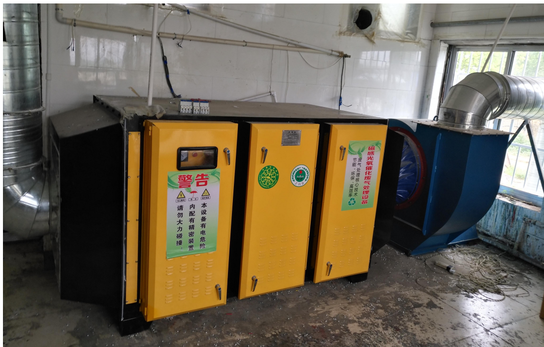
废气处理设施照片
